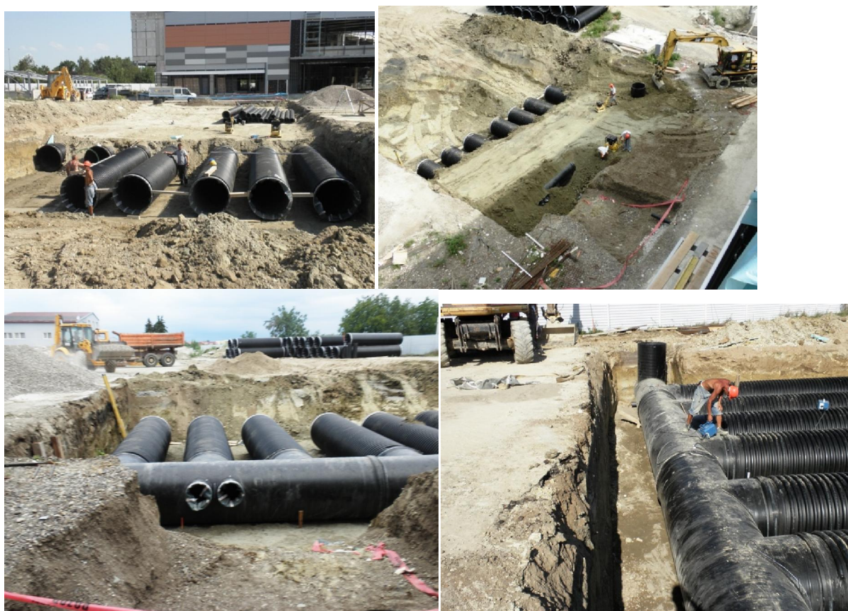
-tank 450m3 ID 1300 Osijek-Croatia
